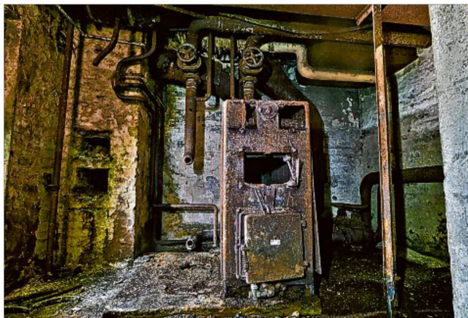
Der alte Heizkessel – verrostet, aber noch vorhanden.
